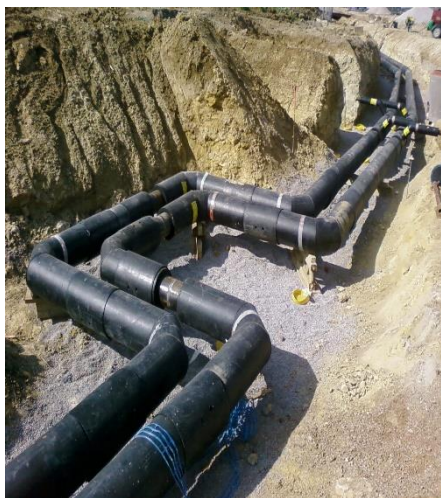
Réseau de chaleur
