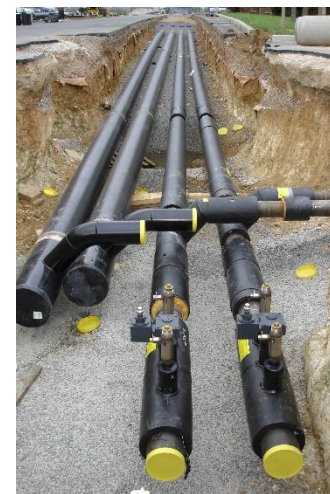
Réseau de chaleur
