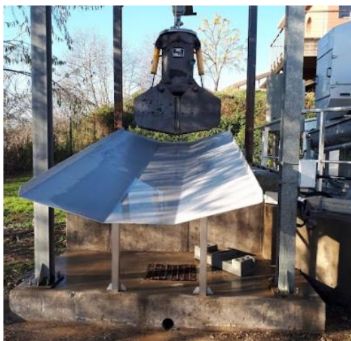
Aménagement d'une dalle béton et d'une goutte de descente des sables. Décembre 2021
