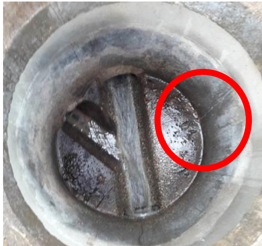
Figure 1 : Infiltration des ECPP dans le réseau d'assainissement (Courmonterral)
