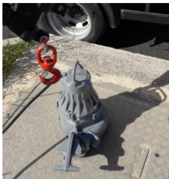
Renouvellement du motoréducteur et de la grille du dégrilleur de la STEP de St Drézéry.
