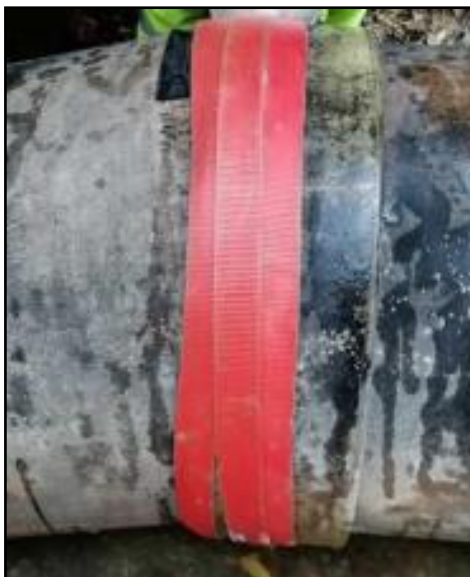
Bande de joint sur conduite
